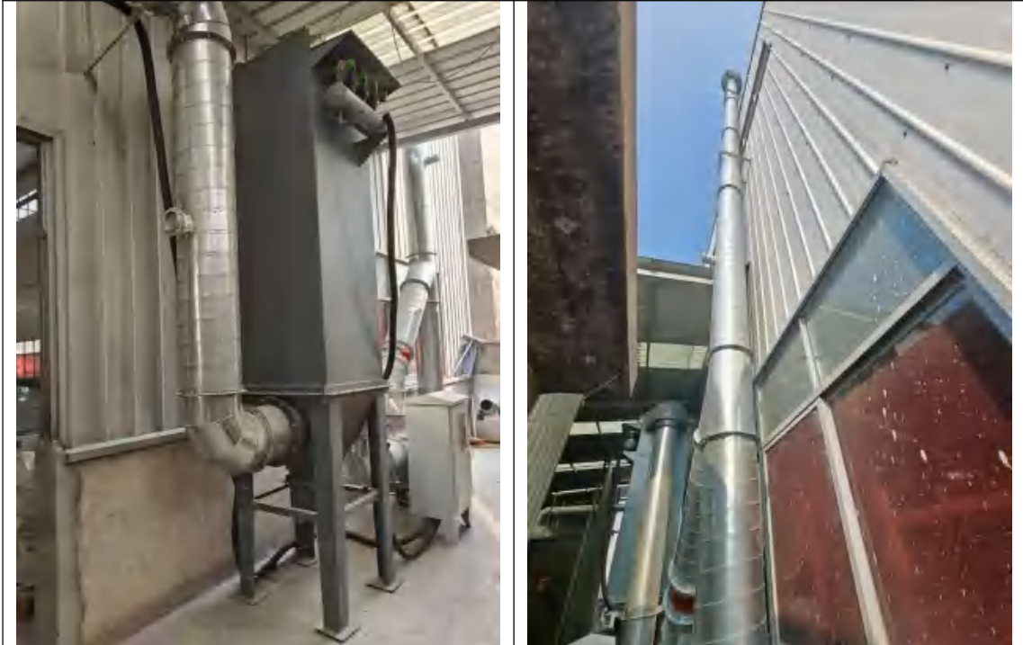
投料粉尘、破碎粉尘：投料粉尘密闭收集、破碎粉尘经密闭罩收集，收集后经布袋除尘器处理，通过 1 根 15m 排气筒（DA002）排放
